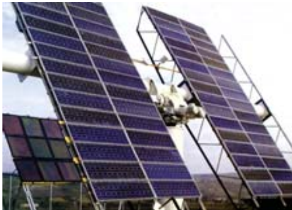
Панели једне шпанске соларне електране
